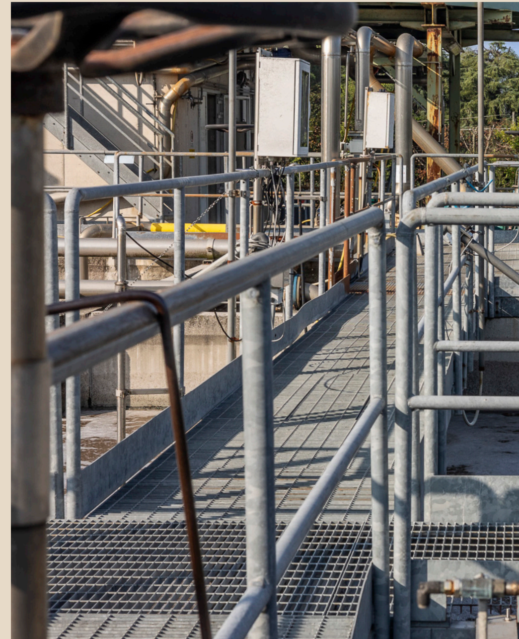
IMPIANTO DI DEPURAZIONE
